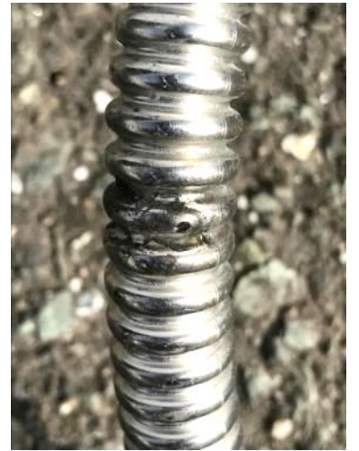
図 穴の空いた フレキシブルチューブ
