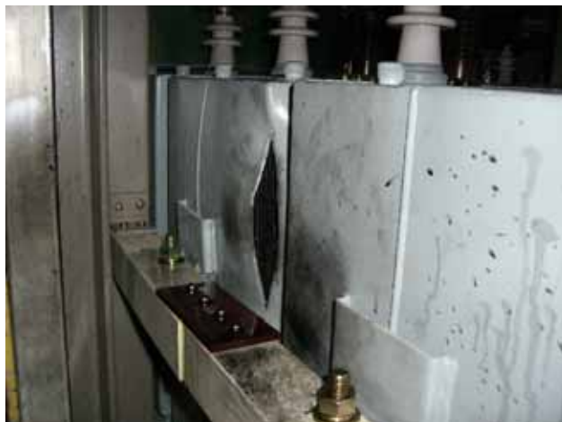
写真1 DTL-PLT電源内コンデンサ破損
