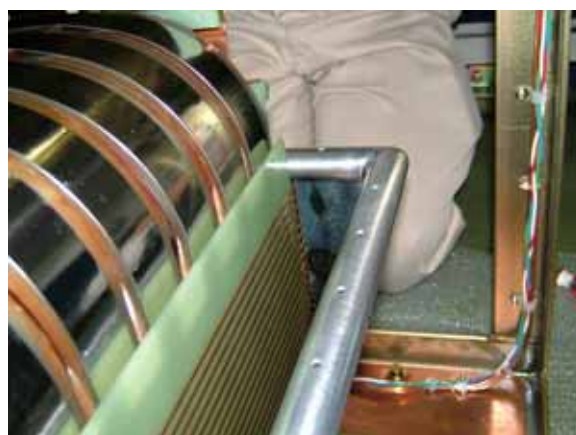
図3:パルストランスの損傷状況。2次巻き線をサポートするFRP板の複数の箇所放電痕が認められ、該当部の2次巻き線にも外側への膨らみ、カーボンの付着が見られた。
