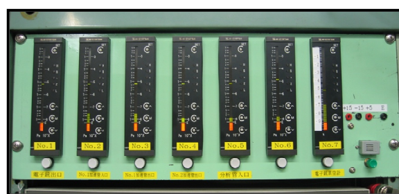
図 4 更新後の制御室真空表示：バーグラフ表示
