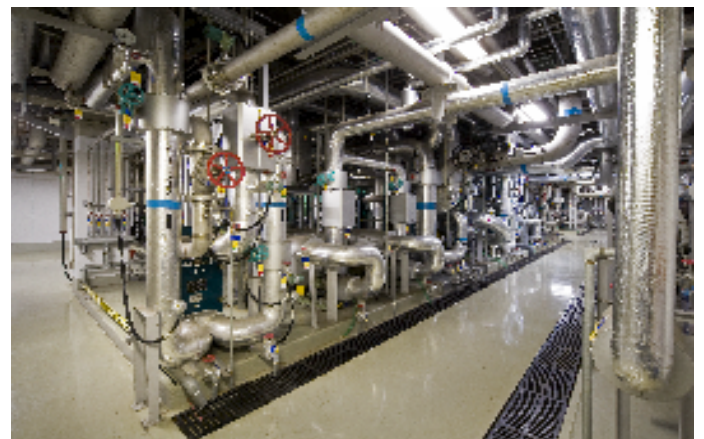
写真2：RIBF 冷却設備
